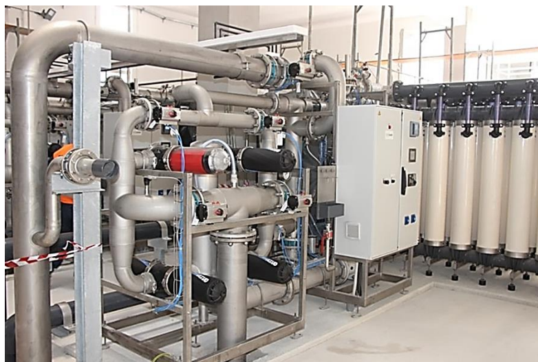
Slika 28. Sustav mehaničke filtracije i ultrafiltracije.
