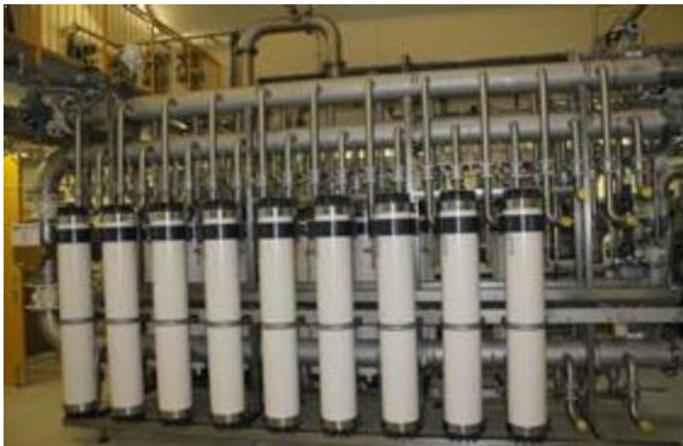
Slika 4.6 - Sustav za prečišćavanje vode pomoću tehnologije ultrafiltracije [10]
