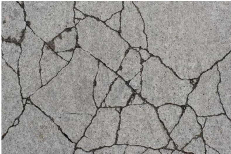
Slika 14. Prikaz pukotine u betonu [19]
