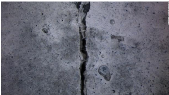
Slika 36. Pukotina na konstrukciji (stanje prije liječenja bakterijama) [86]
