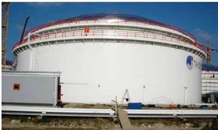
Slika 1.3 Silos za skladištenje naftnih derivata
