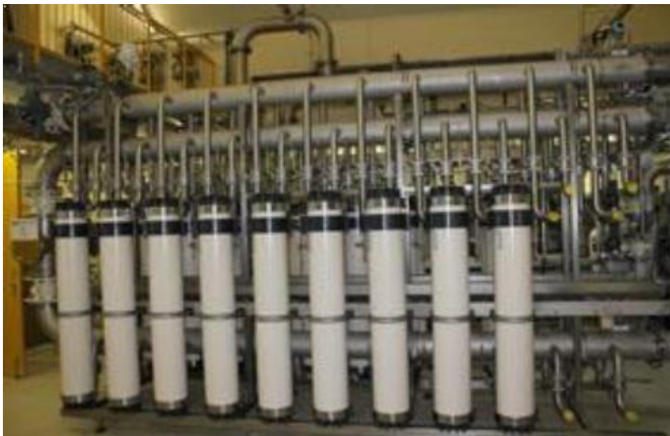
Slika 4.6 - Sustav za prečišćavanje vode pomoću tehnologije ultrafiltracije [10]
