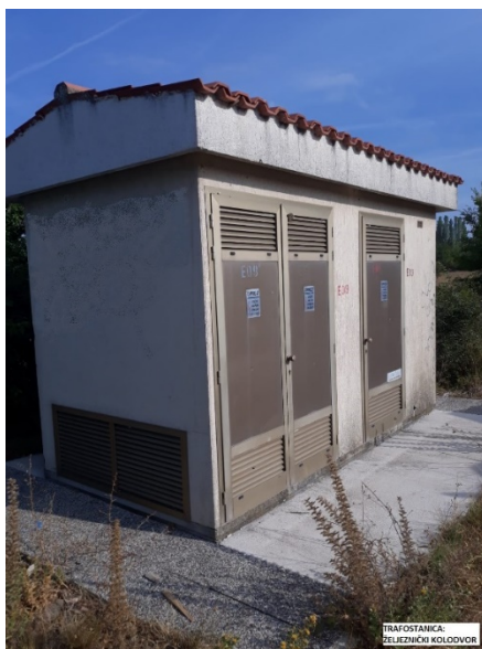
Slika 4.4.2. Trafostanica željeznički kolodvor
