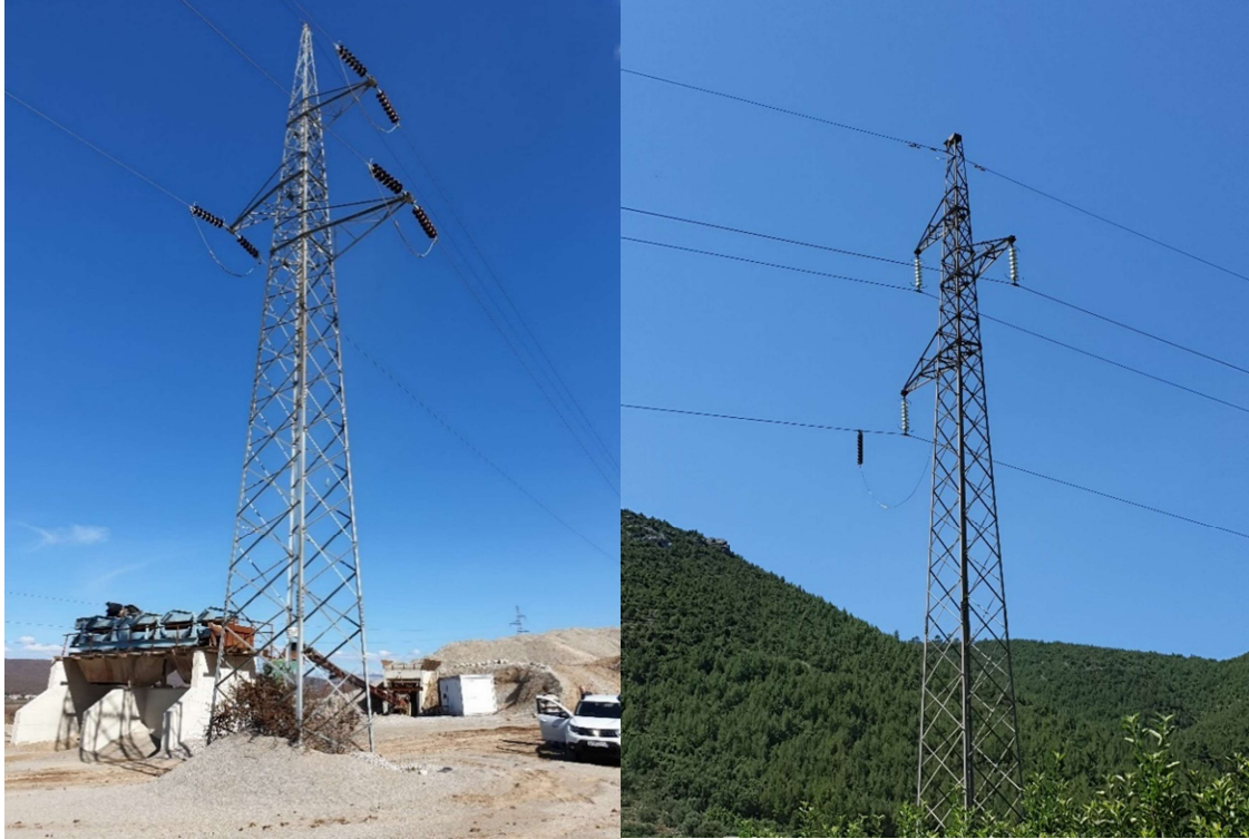
Slika 2.4. Zatezni i nosivi stup nadzemnog voda
