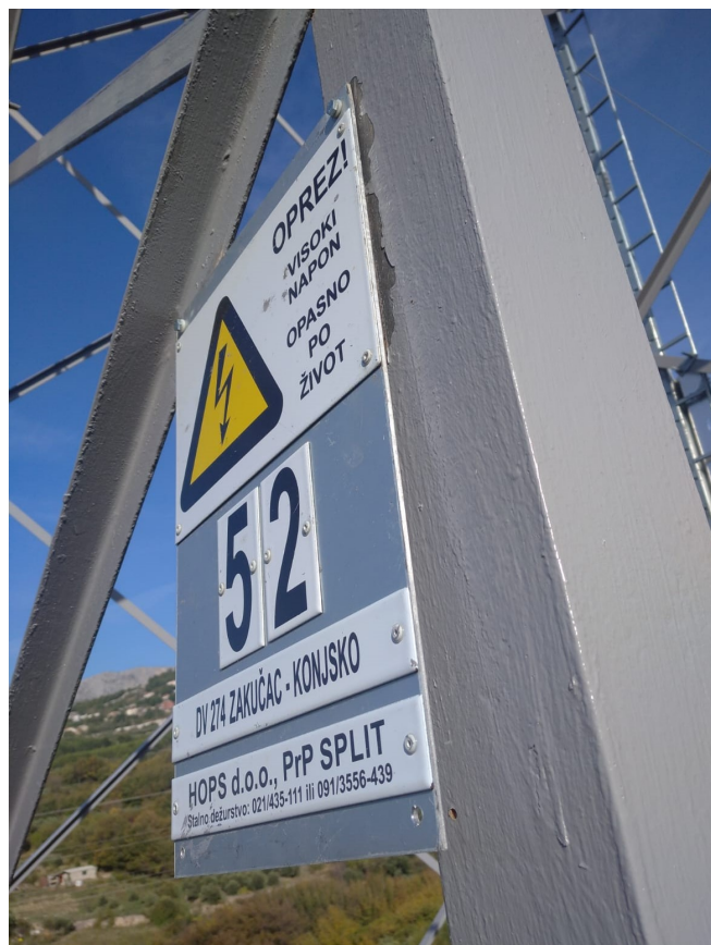
Slika 5.10. Tablica za označavanje dalekovoda
