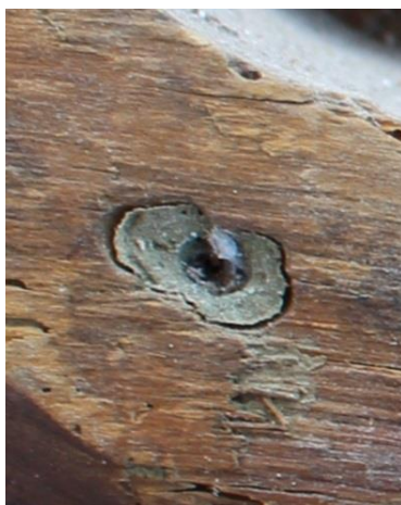
Slika 63 Kit kojim je zapunjeno oštećenje nastalo oko čavla, detalj
