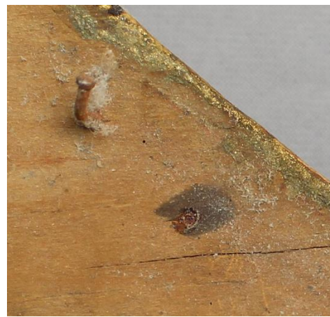
Slika 61 Korodirani čavao te diskoloracija i oštećenje nastali zbog djelovanja korozije na okolno drvo, detalj
